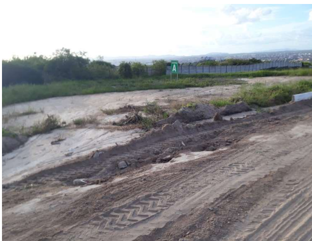
FOTO 06: RUA PROJETADA R-1 (AO LADO DA QUADRA A, ONDE O MEIO-FIO FOI ARRANCADO DEVIDO A ÁGUA PLUVIAL).
