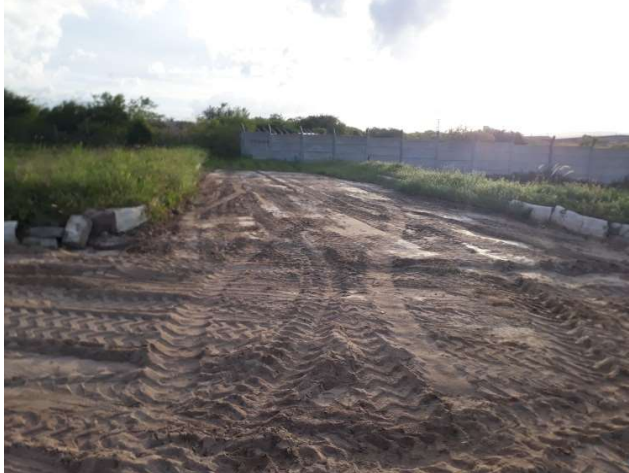
FOTO 16: : RUA PROJETADA R- 4 (ENTRE AS QUADRAS E e F) – TERRAPLENAGEM E MEIO-FIO.
