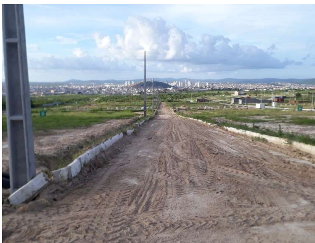
FOTO 09: RUA PROJETADA R-2, (ENTRE AS QUADRAS D e H), TERRAPLENAGEM, MEIO-FIO E POSTES ELÉTRICOS.
