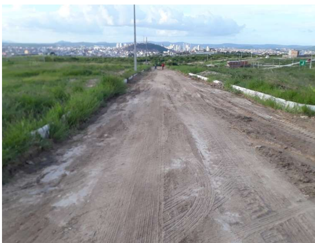
FOTO 11: RUA PROJETADA R-2, (ENTRE AS QUADRAS F e J ) – TERRAPLENAGEM, MEIO-FIO E POSTES ELÉTRICOS.
