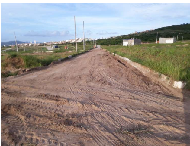
FOTO 15: RUA PROJETADA R- 4 (ENTRE AS QUADRAS I e J) – TERRAPLENAGEM, MEIO-FIO E POSTES ELÉTRICOS.
